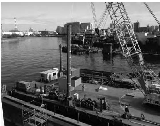
図8-3-4 隅田川台船からの電源ユニットの搬入 (排気フード、燃料タンクが船上)
