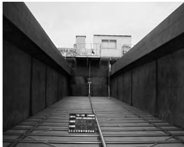
図3-1-2 三河島処理場往復式汚泥かき寄せ機
