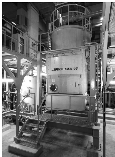
図6-4-2 二重円筒加圧脱水機の外観
