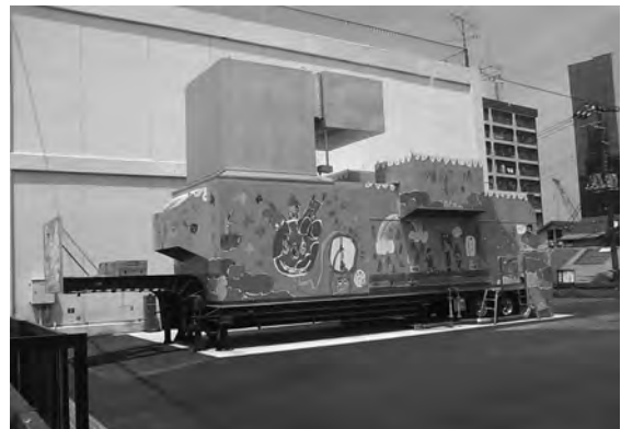
図8-3-3 羽田ポンプ所簡易設置型電源ユニット (トレーラに搭載された移動電源車)
