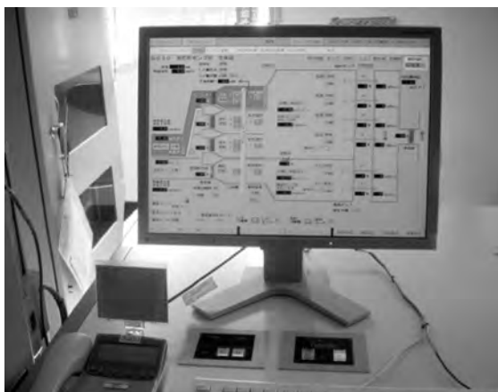
図9-2-6 小規模監視制御設備を設置した被制御ポンプ所（明石町ポンプ所）
