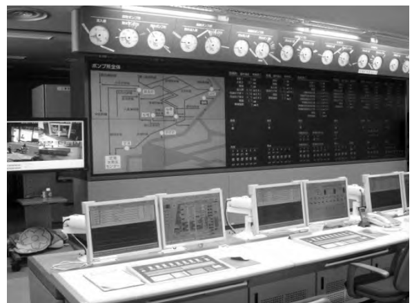
図9-2-7 遠制ポンプ所の監視制御設備（桜橋第二ポンプ所）
