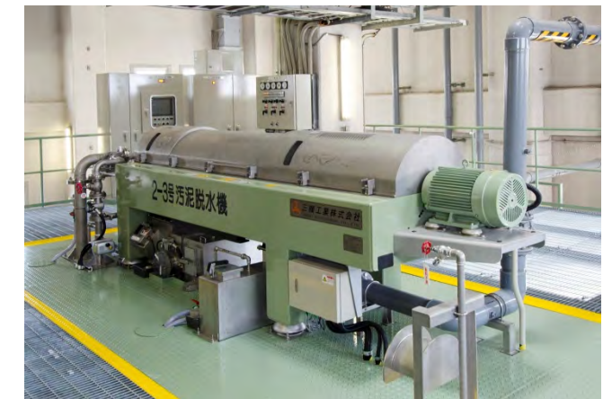
図5 SANDEC G3 設置状況
