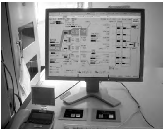
図9-2-6 小規模監視制御設備を設置した被制御ポンプ所（明石町ポンプ所）
