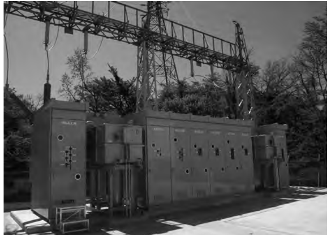
図8-2-2 南多摩水再生センター 72kV乾燥空気絶縁C-GIS
