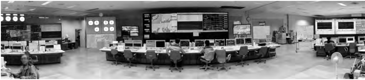
図9-2-3 中央監視制御設備（砂町水再生センター）
