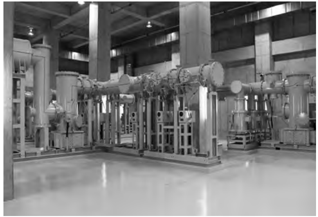
図8-2-1 砂町水再生センター 154 kV受電設備
