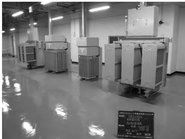
図8-2-3 トッランナー変圧器の設置状況
