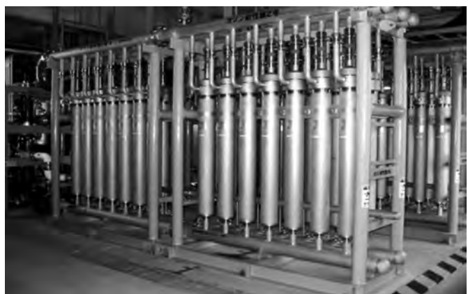
図 11-1-2 オゾン耐性膜ろ過施設
