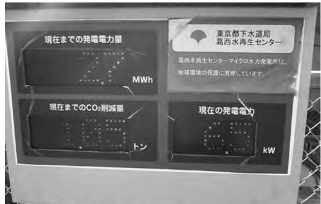
図 11-4-4 葛西水再生センターマイクロ水力発電表示パネル
