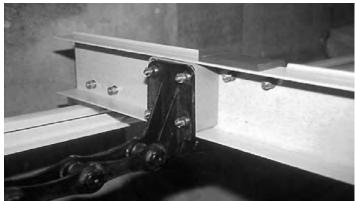
図3-1-4 チェンフライト式汚泥かき寄せ機プラスチックチェンとFRP製フライト
