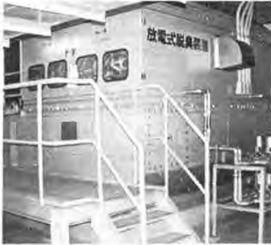
写真7-6 放電脱臭装置
