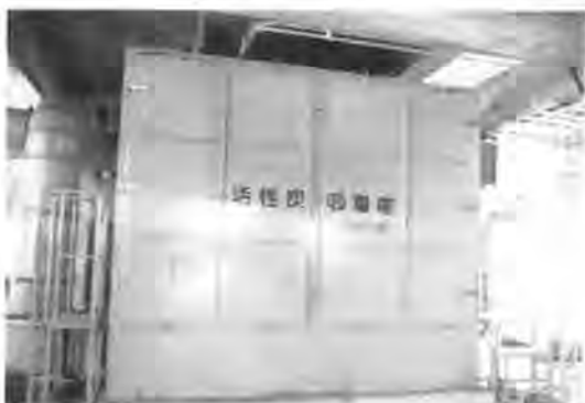
写真7-3 活性炭吸着塔
