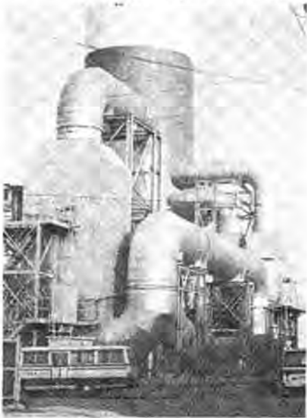
写真7-5 脱硝脱臭装置
