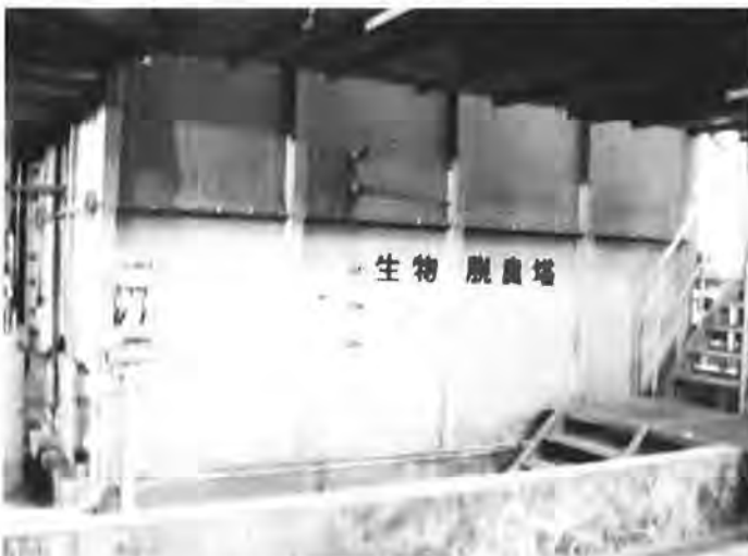
写真7-4 充填塔式生物脱臭装置
