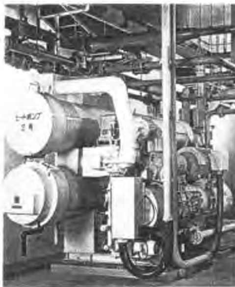
写真6-2 ヒートポンプ
