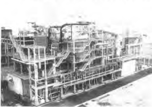
写真5-8 流動焼却炉の例
