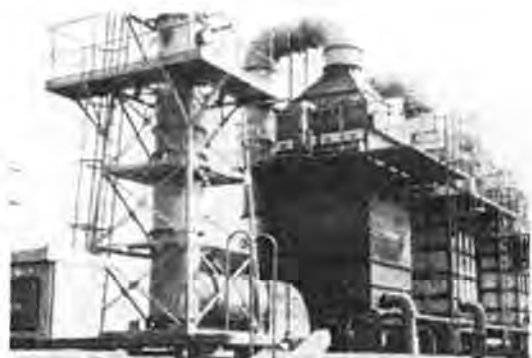
写真7-2 酸アルカリ洗浄の充填塔
