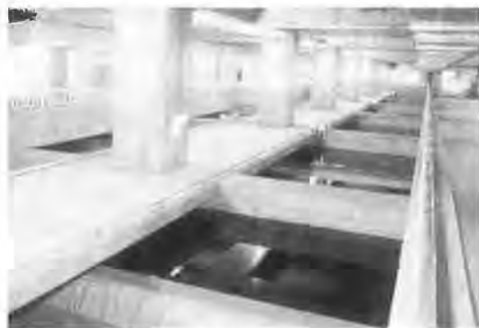
写真4-2 落合処理場450,000m 3 /日急速砂ろ過施設
