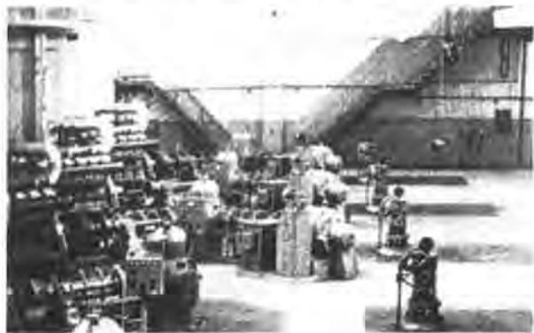
写真2-5 ディーゼルエンジン及び電動機掛け立軸斜流ポンプ(桜橋ポンプ所)
