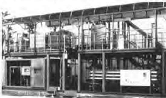
写真4-5 落合処理場50m 3 /日逆浸透膜施設
