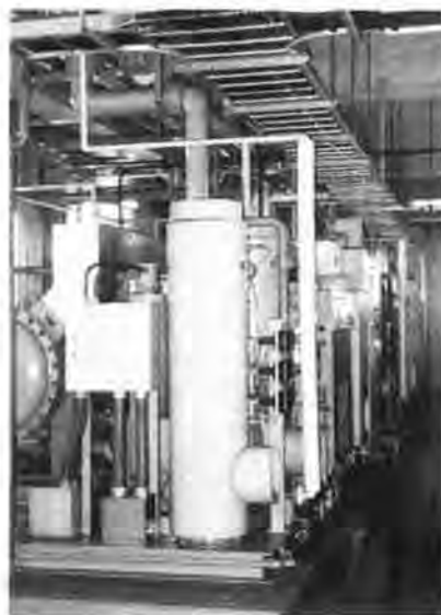
写真4-6 オゾン発生器
