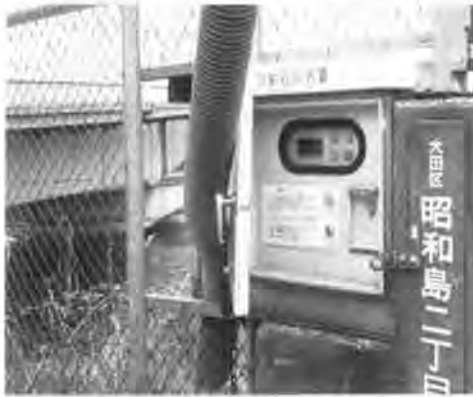
写真4-3 コイン式処理水供給装置
