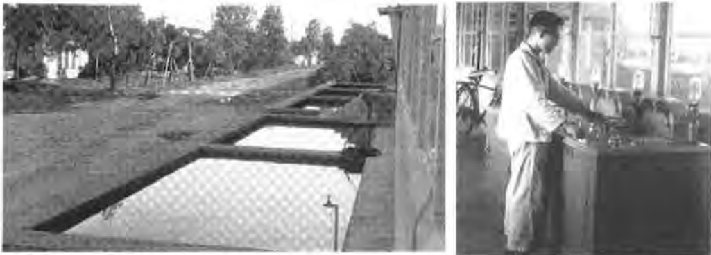
写真4-1 三河島処理場最初の処理水再利用施設(S38.10撮影) 左：砂ろ過池 右：砂ろ過制御盤
