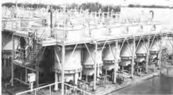
写真4-4 多摩川上流処理場移動床式砂ろ過機
